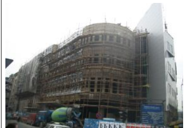
Belgrado, ajuste de las desviaciones de las placas de entrepiso \varnothing 15 cm el peso menos de 40 kg/m 2
